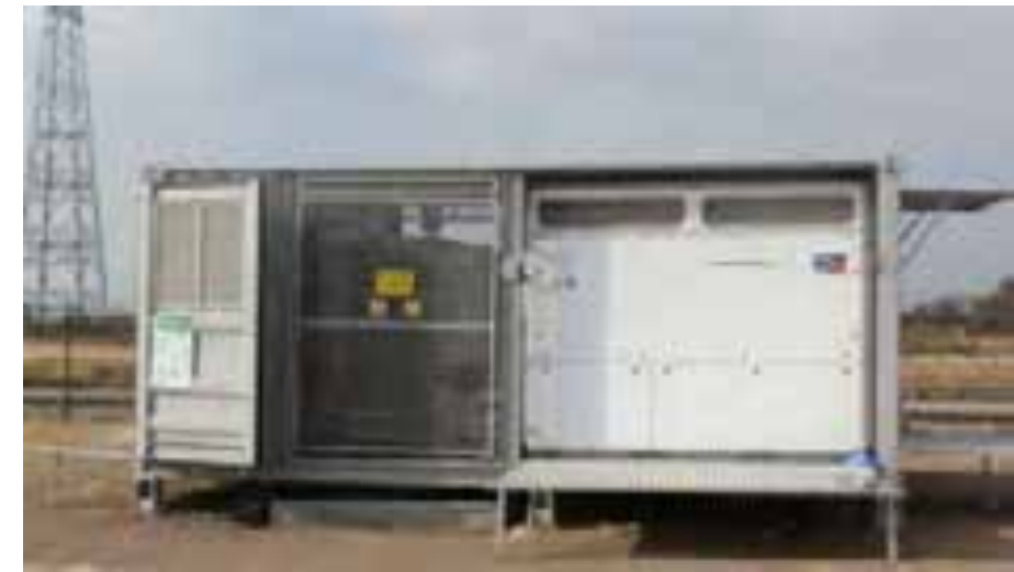
Exemple de modules intégrant transformateurs et onduleurs Source : dossier de permis de construire
